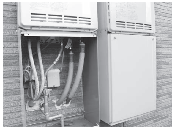
無線ユニットは給湯器BOX内に収納
